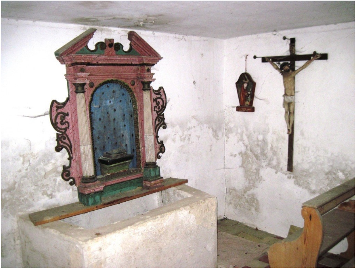
Die sogenannte Pestkapelle, im Kern aus dem 17.-18. Jahrhundert steht südlich des Ortes erhöht an der Straße nach Landsberied. Die Kapelle ist stark renovierungsbedürftig, das Standbild im Altar fehlt, die Tafeln der Kreuzwegstationen sind in eine Kirchenbank gestapelt.
